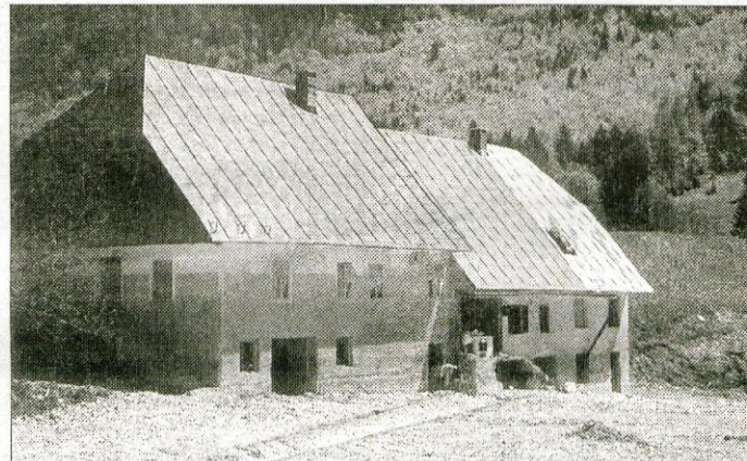
Pižijeva hiša bo porušena. Plaz jo je tako poškodoval, da ni vredna popravila. Takoj, ko bodo znane lokacije, bodo zgradili novo.
