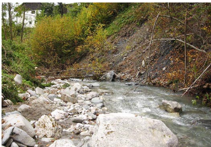
Slika 3 • Poškodovana struga hudournika Češnjica skozi naselje Rudno pred sanacijo (Vir: arhiv VGP, d. d., Kranj)
