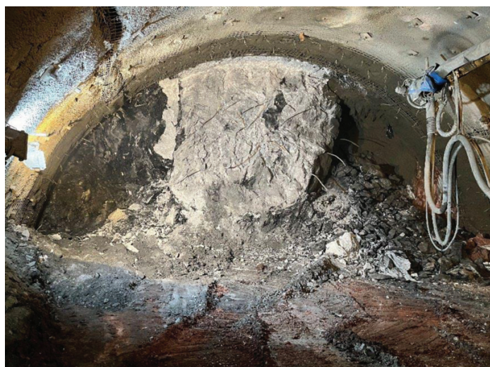
Slika 5: Izkopno čelo kalote po dinamičnem zrušku, ki ga je spremljalo intenzivno sproščanje nakopičenih hribinskih napetosti v obliki tresenja širšega hribinskega območja okrog predorske cevi.
