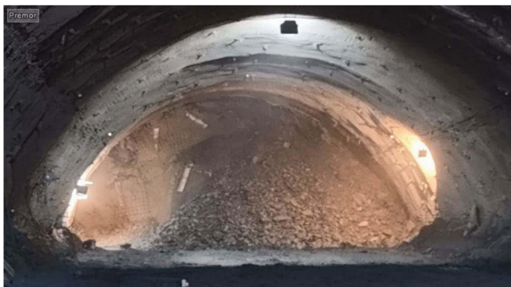
Slika 6: Izkopno čelo kalote po dinamičnem zrušku dne 13.08.2023, ki ga je spremljalo intenzivno rušenje krovinskih plasti tektonsko močno poškodovanega in zdrobljenega meljevca.
