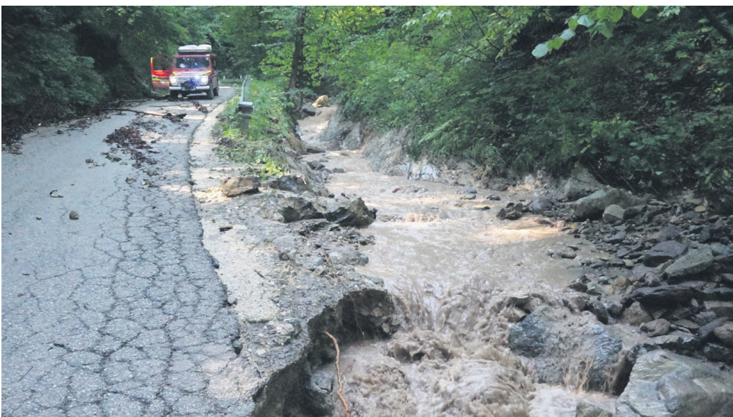
Hudourniška voda je poškodovala veliko občinskih cest.
