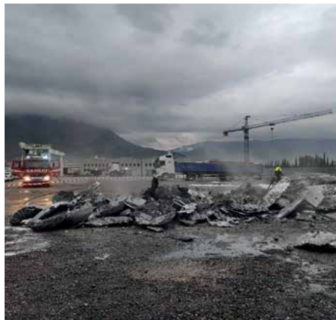
Slika 2: Pogled na požarišče
