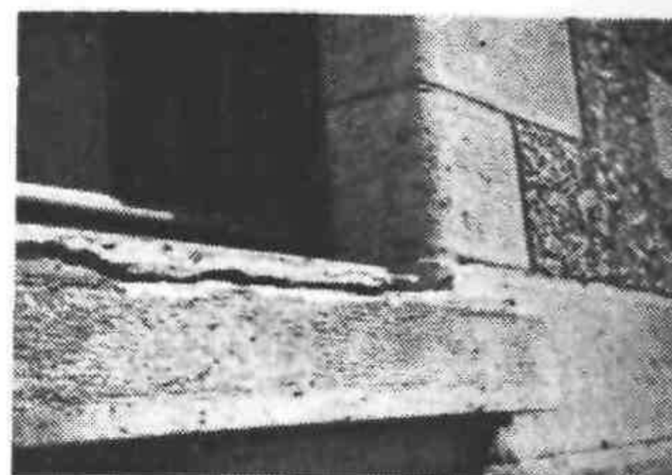
Sl. 5. Podklade pri oknih hiše Miklošičeva cesta 16
