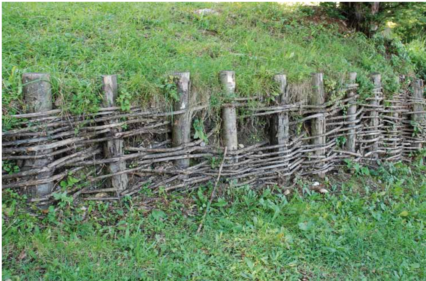
Slika 13: Podporna ograja iz vrbovega pletiva. Foto: Andreja Mihelčič Koželj, 2007.
