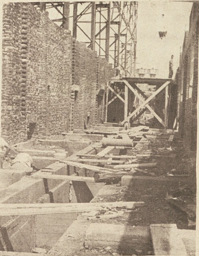
Nered na objektih in deloviščih ter nezavarovani jarki in jame so stalen vir poškodb pri delu. Na sliki se vidi tudi nezavarovan delovni pod, kjer z igličastim dvigalom odvezemajmo samokolnice in druga bremena
