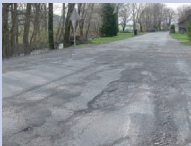
Nekatero občinske ceste so v slabem stanju. Na fotografiji odsek od Tometovega mostu proti Mednemu.
