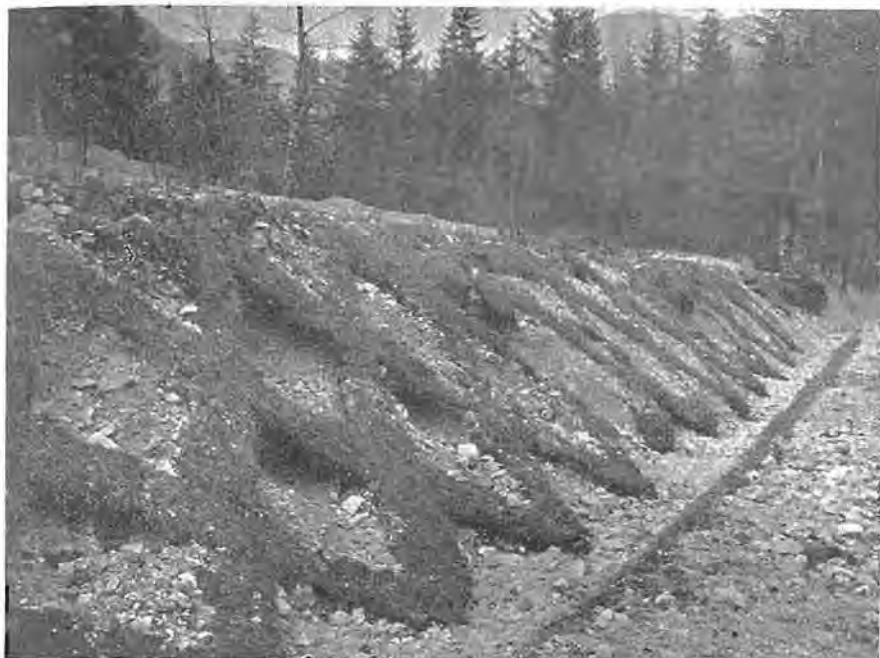
Slika 8. Nesmotrno in' nevešče zavarovanje brežin s travnimi rušinami na cesti v Logarsko dolino (orig.)
