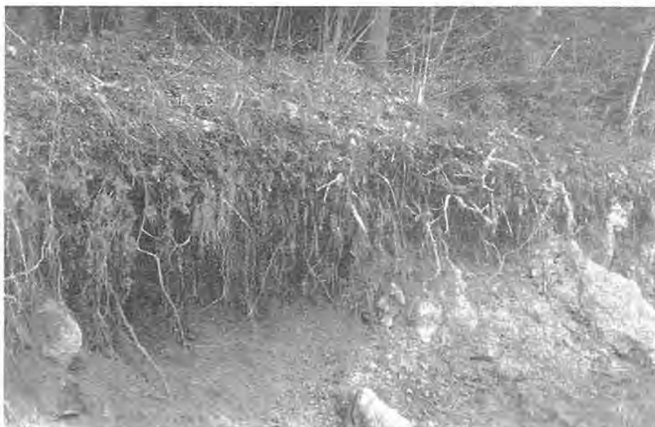
Slika 4. Neizoblikovan zgornji rob cestnega odkopa (foto: ing. F. Šubic)
