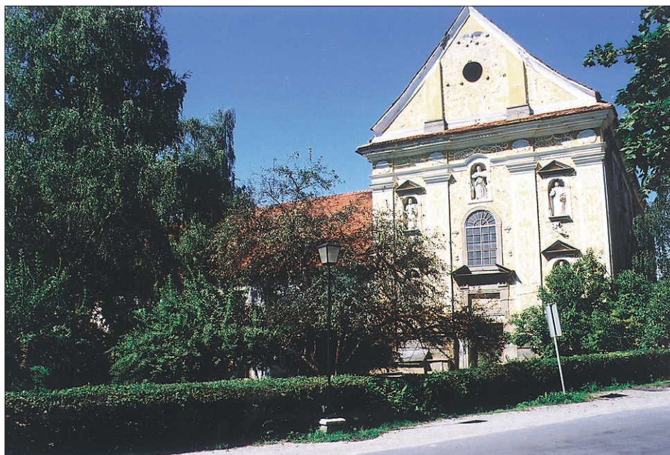
Dominikanski samostan je gradbeno in statično tako dotrajan, da ogroža varnost ljudi. Letos naj bi obnovili kritino in ostrešje, saj v objekt že teče. Foto: Črtomir Goznik
