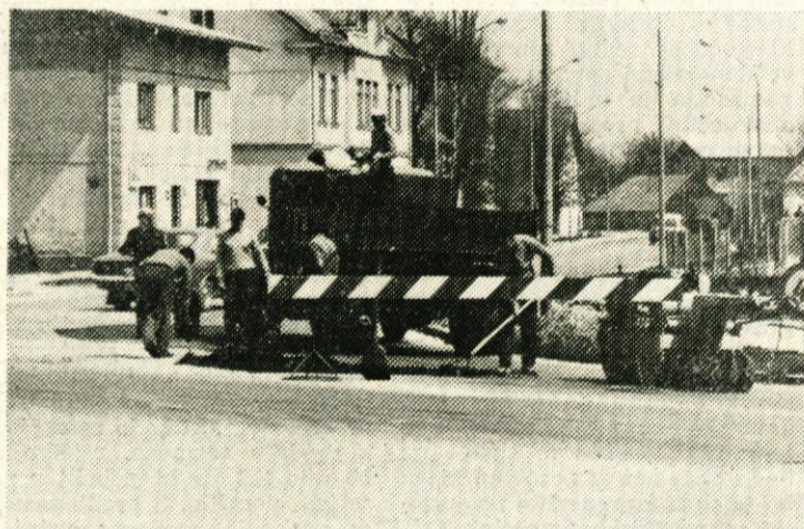
Domžalsko komunalno podjetje je letos hitro poskrbelo, da so bile na naših cestah odpravljene posledice zime. Asfalterji so zakrpali rane na cestiščih, kar pa je, vsaj za Ljubljansko cesto v Domžalah, le zasilna rešitev. Cesta vedno glasneje terja novo prevleko
