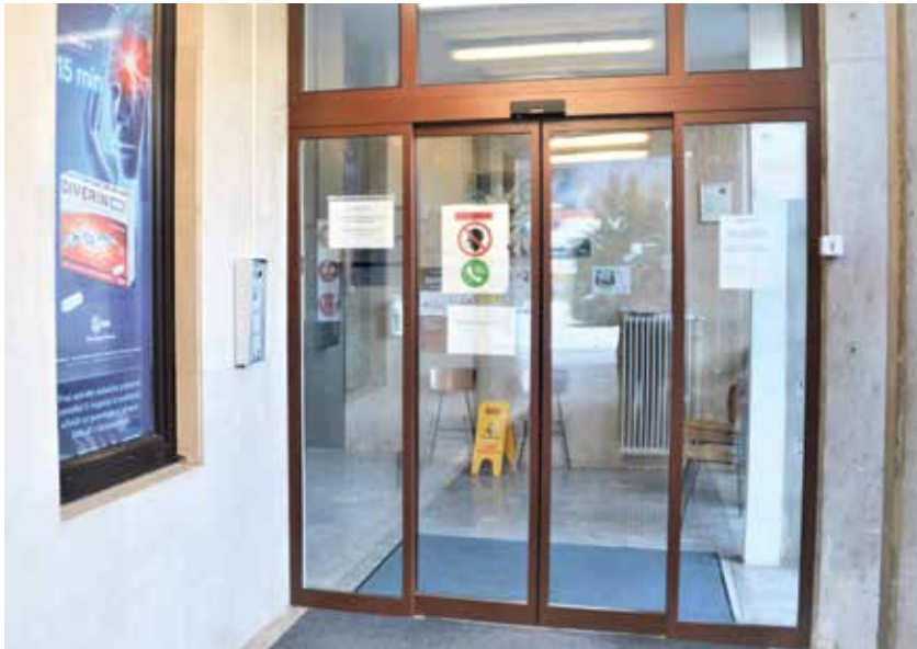
Avtomatski novi vhod v ZD Prebold
