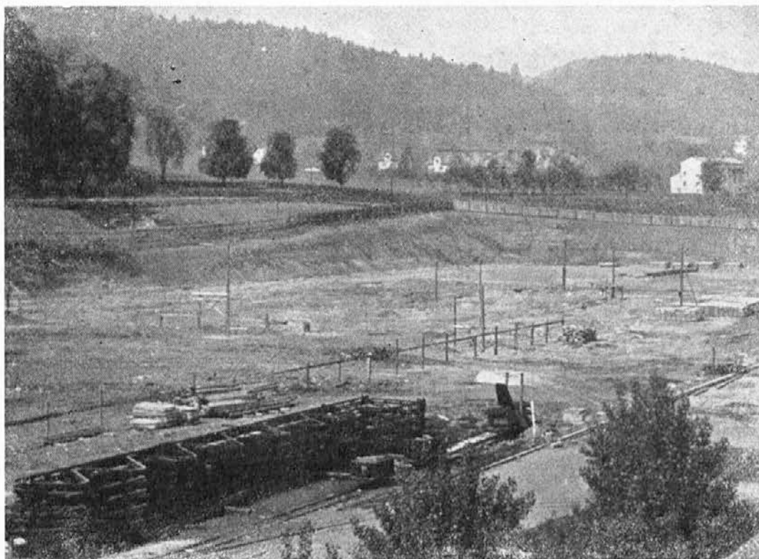
Tu bo naša nova valjarna. Temelji so že položeni, zbirajo se konstrukcije. Ko bo naš list izšel, bo na prostoru že vse drugače, verjetno tudi že streha nad vsem skupaj za nadaljnje delo
