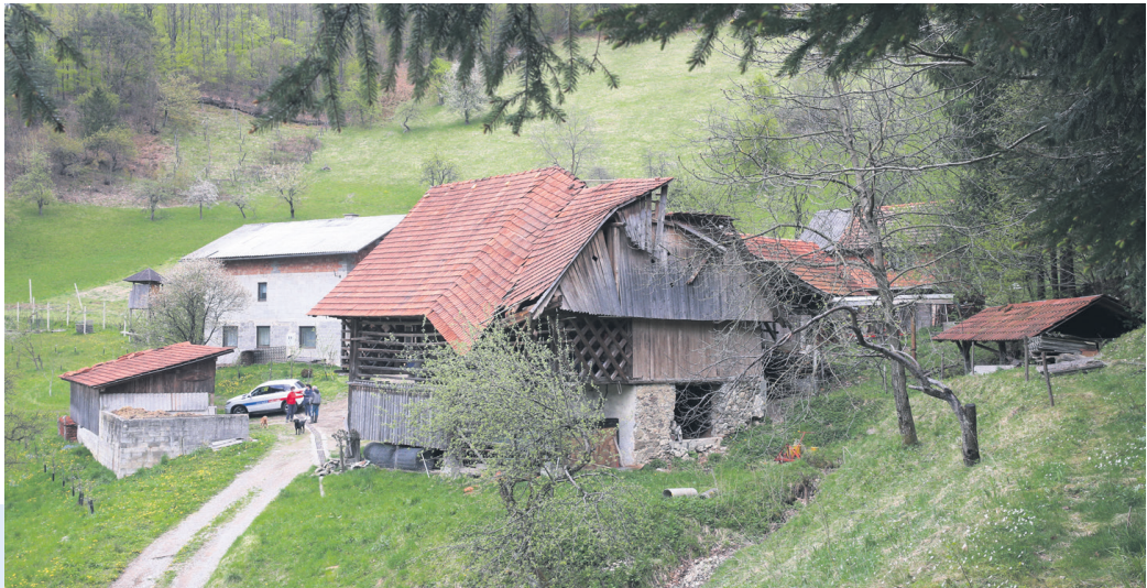
Zakonca Razpotnik iz Matk ob vsakem pogledu na porušeno streho domačega kmečkega gospodarskega poslopja zaboli pri srcu.
