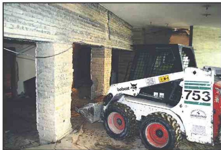
Stroji v nekdanji garderobi kulturnega doma
