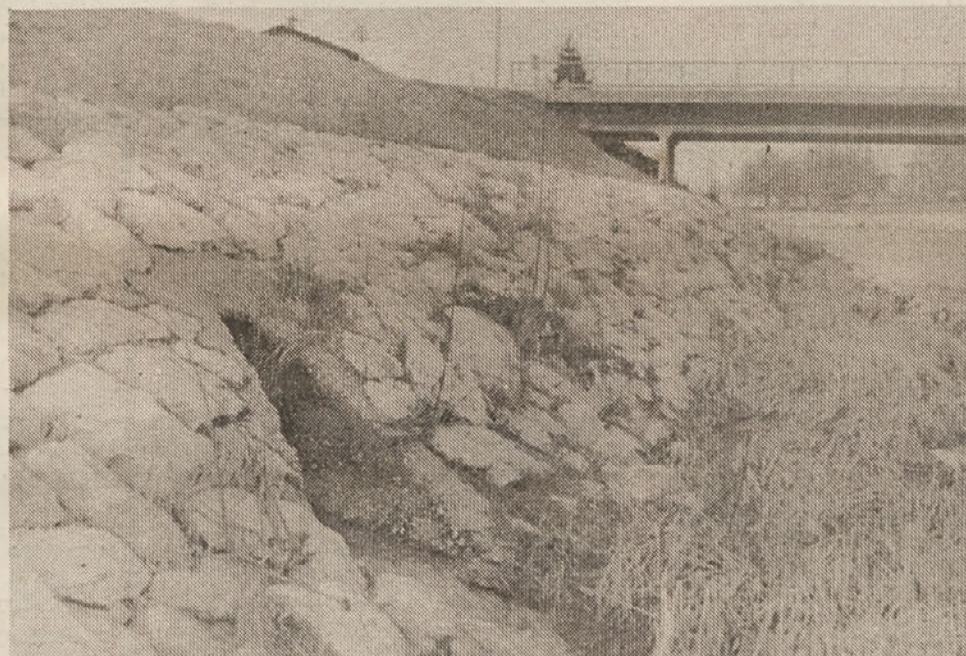
Edini kanal iz Lisc, 50 metrov niže od Čopovega mostu, sedaj že deluje. Ali zajema vso kanalizacijsko mrežo naselja?
