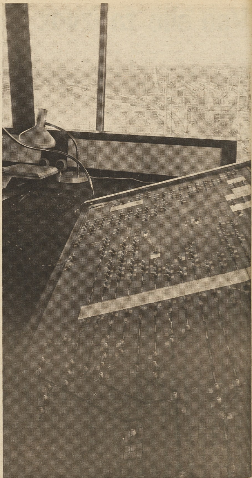
Panorama s kodno napravo za daljinsko upravljanje s prometom na progi Ljubljana – Jesenice.
