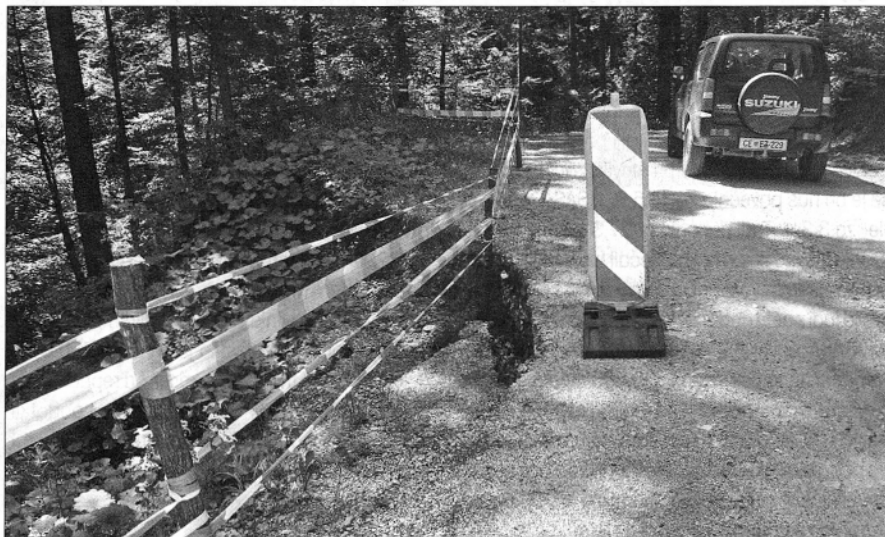
Zaradi plazu pod občinsko cesto Sluga-Slapnik-Mačkin kot je cesta prevozna samo še za osebna vozila (foto: Marija Lebar)
