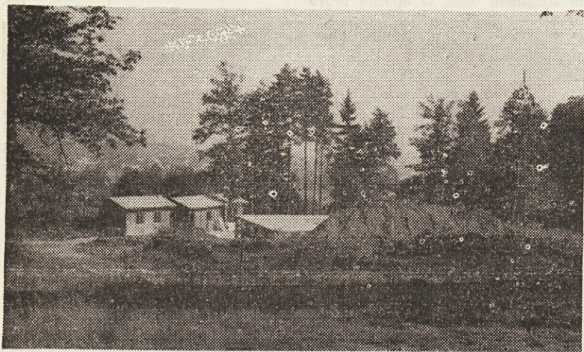
Ko so začeli izkopavati za temelje, so imeli na gradbišču kmalu kar malo jezerce
