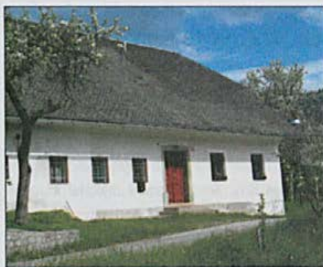
Slika 2: Kamnita streha, pokrita s ploščicami spodnjepermijskega skrilavca, v Dolenji vasi. Ploščice so slabše kvalitete in so nekatere že zamenjane. Foto: arhiv DECOP
