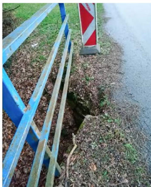
Stanje mostu na potoku Peklača
