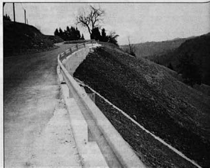
Cesta med Govejkom in Razpotjem je sicer deloma popravljena, toda do Idrije – je še tako daleč
