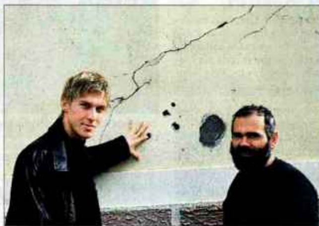
V Posočju bodo posledice potresa odpravili tudi s pomočjo prijateljev Bogdana Norčiča. Na sliki si Bine Norčič skupaj z domačini ogleduje poškodovane hiše.
