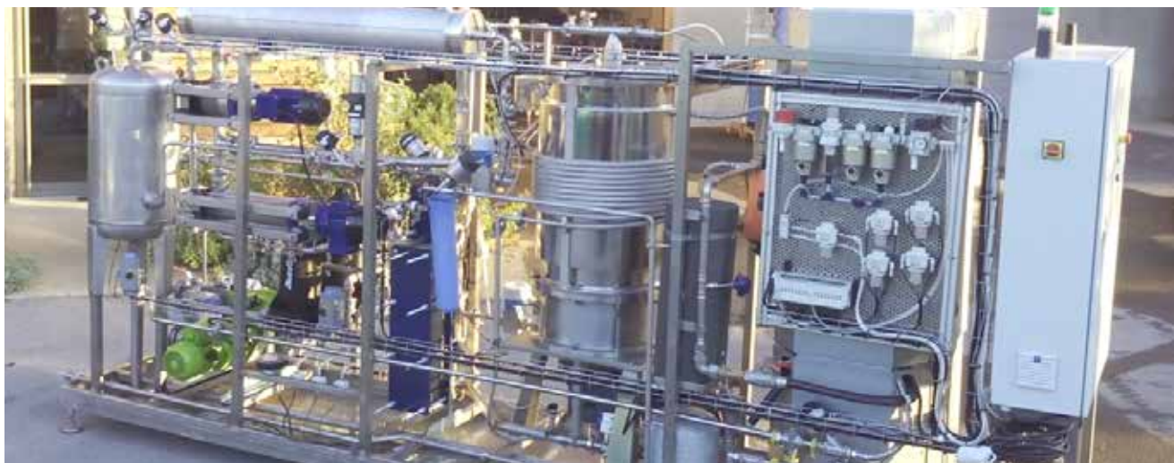
Slika 2 : SMC komponente instalirane v čistilni napravi
