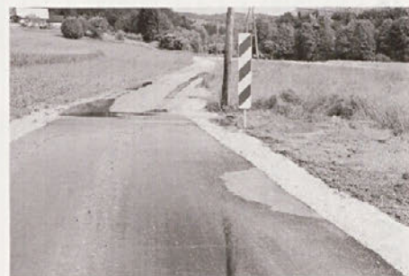
Konec asfaltna prevleke - voda na sosedovo zemljišče
