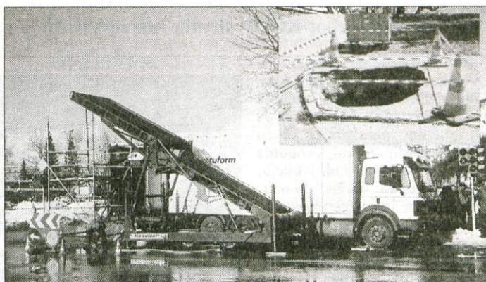
Primer podora zaradi poškodovane kanalizacije na Kebetovi ulici in nova metoda obnove.
