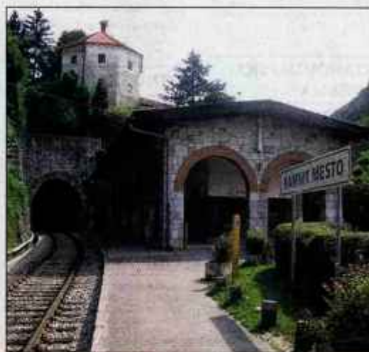
Plečnikova železniška postaja je potrebna prenove.
