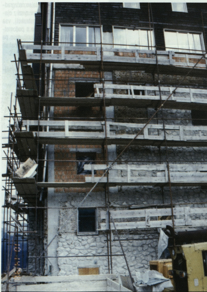
Slika 6: Celoten hotel je bil konstrukcijsko ojačen: porušene zidove so zamenjali armirani opečni zidovi in z vogalne armiranobetonske vezi. Razmeroma draga popotresna obnova je bila ekonomsko upravičena le zaradi nedostopne lege objekta in specifične arhitekture.
