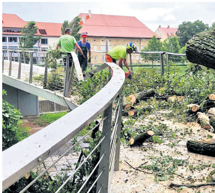
Podrta lipa je v torek tako zaprla in poškodovala Splavarski most v Celju. Sodelavci Zelenic so se hitro lotili urejanja razmer. (Foto: arhiv MOC)
