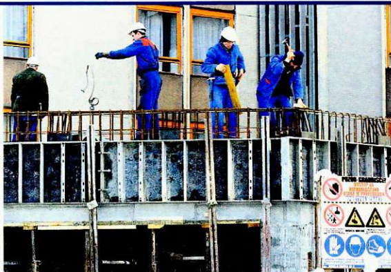
V gradbeništvu so zamude s plačili izrazito vidne.
