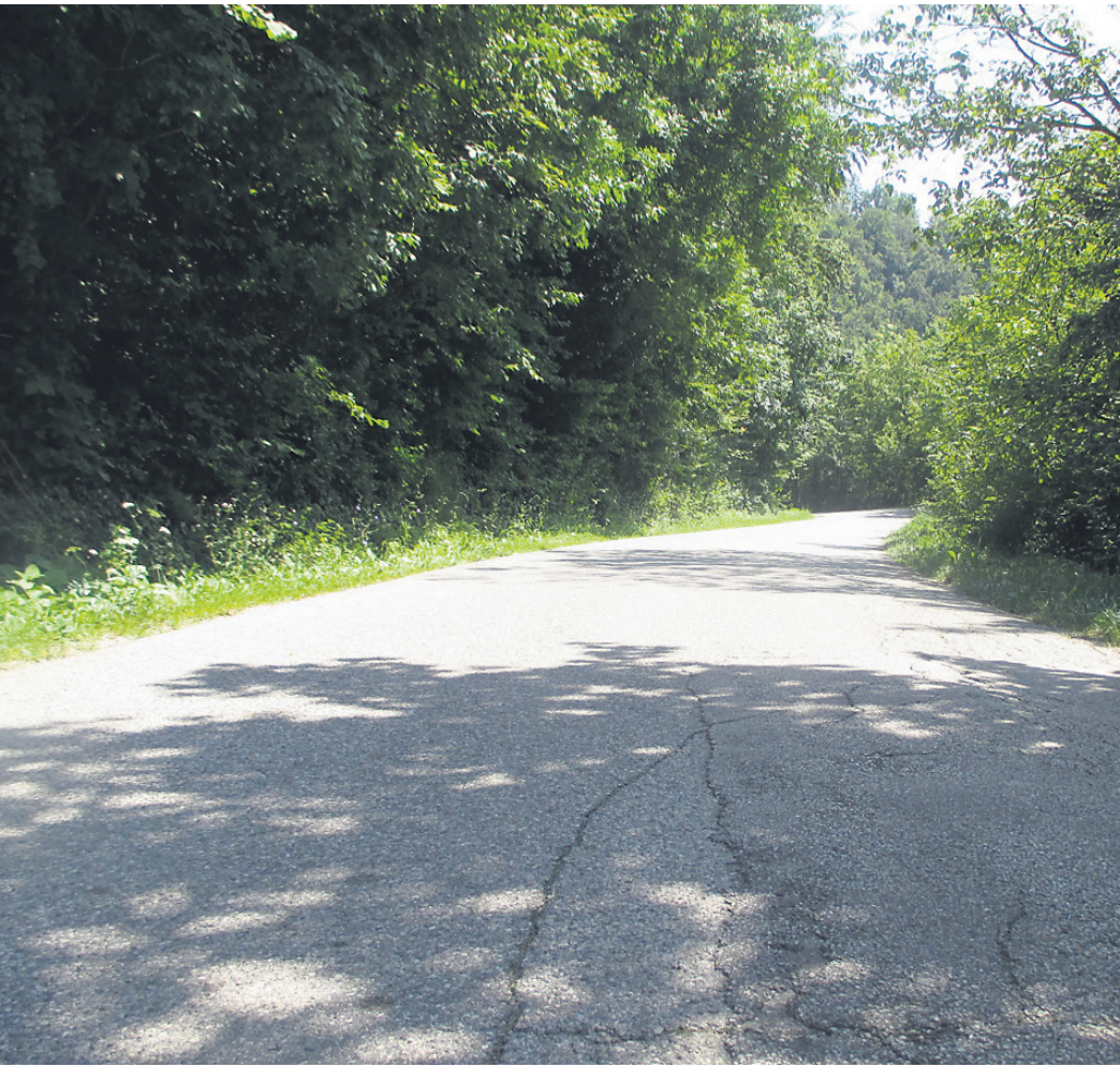
Sanirati bo treba okoli 640 metrov poškodovane ceste.
