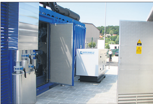
Elektrarna ne pomeni velikega posega v prostor.
