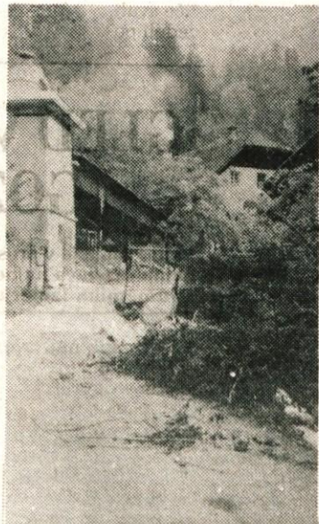
Cesta se je udrla — Na Zgornjem Plavžu na Jesenicah je nedavno obilno deževje tako načelo hribovito pobočje (pri Lesnoganterijemskem obratu), da se je cesta, ki vodi do žage, za polovico svoje širine udrla. Zemlja se je pogreznila in zdrsela proti spodnjemu objektu. Dokaj ozko cesto so zavarovali in primerno označili, vožnja po njej pa ni mogoča. — Foto: D. Sedej
