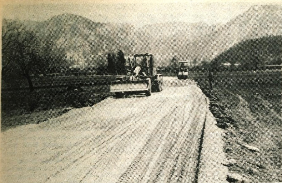
Begunje — Letošnja zima ni prizanesla marsikateri cesti na Gorenjskem, nekatere je tako hudo poškodovala, da je bila malo hitrejša vožnja po njih že kar tvegana. Delavci imajo te dni dovolj dela, da jih bodo pokrpali, tudi cesto od Radovljice proti Begunjam, na kateri asfalt pač ni vzdržal...
