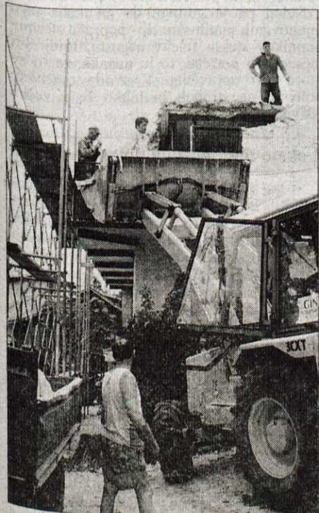
Niso redki primeri, ko sanacija po potresu v sedemdesetih letih ni bila primerna. Nov železobetonski strop le na pol naslonjen na zid, ga je kot nož prerezal. Rešitev je bila samo ena: popraviti napako in nato šele nadzidati.
