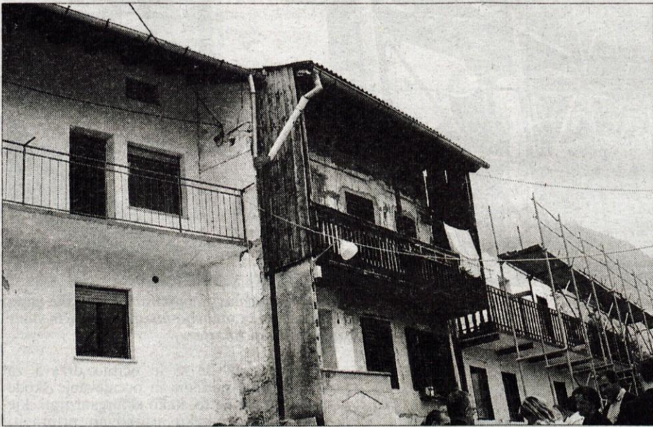
Primer treh medsebojno povezanih hiš: leva je že praktično sanirana, desna je sredi zahtevne rekonstrukcije, lastnik srednje pa se za obnovo ne zmeni. Kako vse to trdno povezati?
