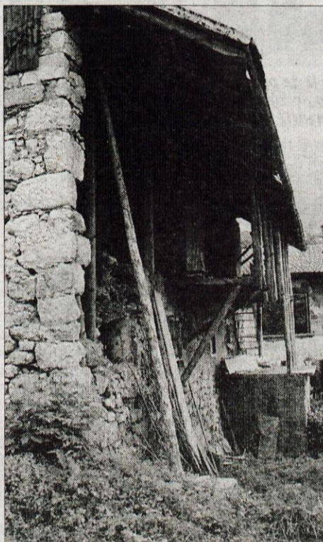
Zlasti pri gospodarskih poslopih se je pokazala stara gradnja: brez temeljev, celo z okroglimi kamni, vmes pa le ilovica. Hlev v vasi Magozd bo potrebno celo utrditi, da ga bo mogoče varno podreti.
