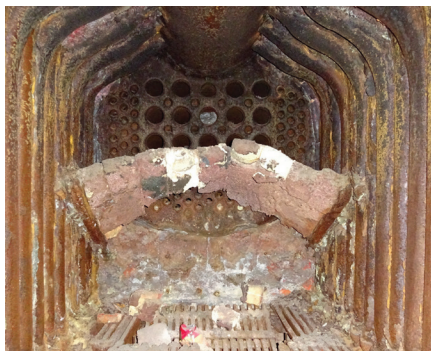
Notranjost brotanovega kotla
