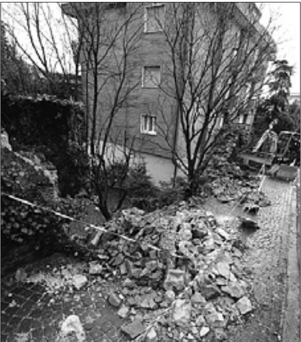
Porušen zid na Ulici Romagna
