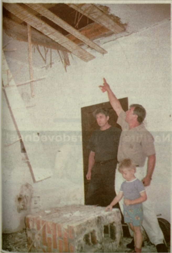
Dimnik je predril strop in treščil v spalnico.
