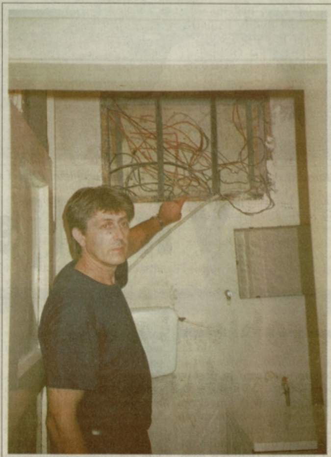
Električna napeljava v kopalnici Rudija Kladnika. Kdo se bo lotil nujnih popravil v hiši, lastnik hiše ali njeni stanovalci? Pravdanje je doslej terjalo lepo vsoto denarja.
