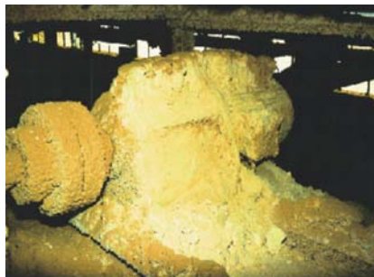
Slika 3. Sloj gorljivega prahu
