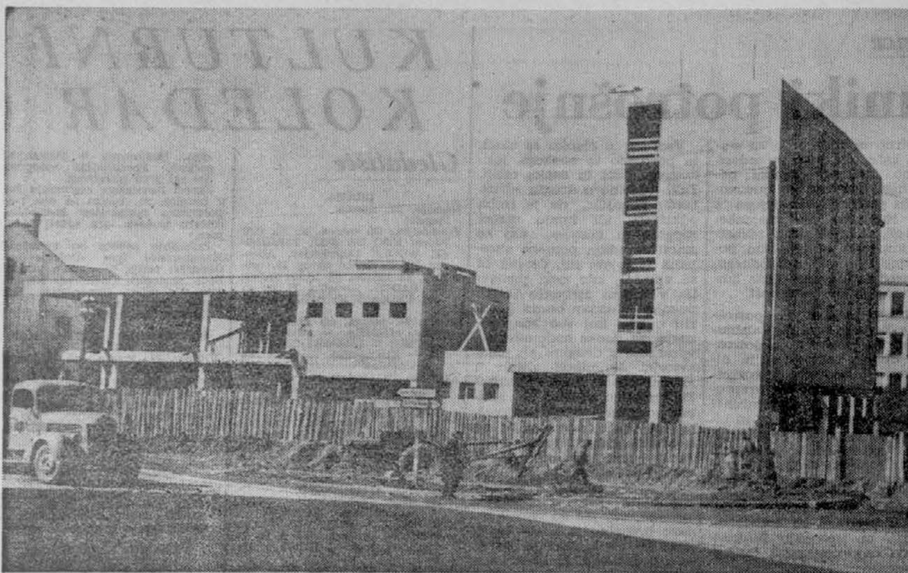
NOVA (TURISTIČNA) PERSPEKTIVA SOBOTE — V pomurski metropoli so končno dobili vsa zagotovila — tudi finančna, da bo novi hotel dograjen že konec tega leta. Velik gostinski obrat s hotelom (63 ležišč), veliko restavracijo in v vsem ostalimi pritlikalnimi naj bi postal stebel turizma v tej obsejni komuni, kjer se za zlasti razvil maloobsejni promet s sosednjo Avstrijo. V Pomurju pa si kmalu obetajo tudi prihodi madžarskih gostov.
