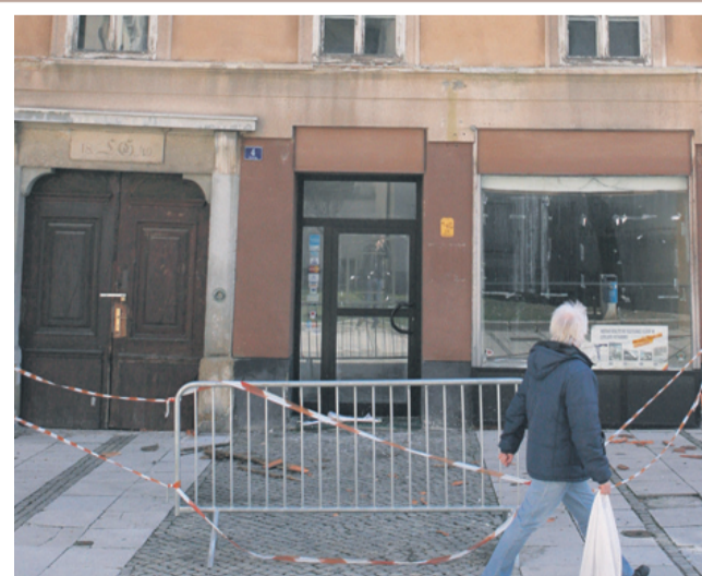
Pred hišo na Glavnem trgu 4 samo postavitve zaščitne ograje z opozorilom za mimoidoče ni dovolj.
