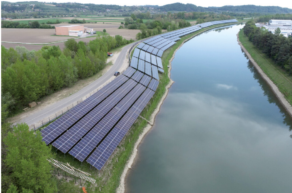
Sončna elektrarna Zlatoličje-Formin Obstoječi segment 5
