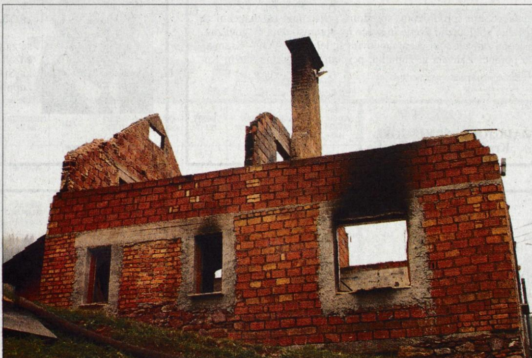
Ostalo je le ožgano zidovje.
