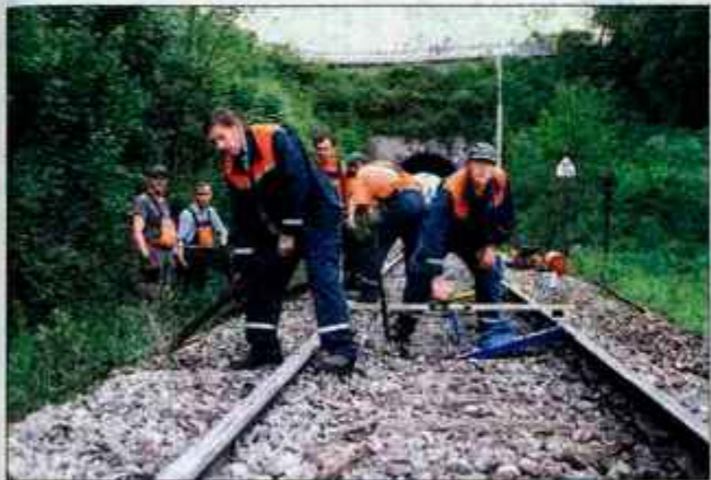
Poškodovano progo so popravljali še v petek ob dveh popoldne, ko so jo spet odprli.
