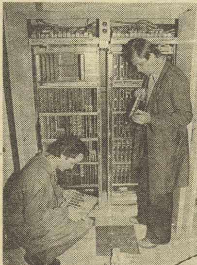
Elektromehanske centrale so zamenjale elektronske in treba je bilo usposobiti veliko novih mladih strokovnjakov. Na sliki: Preizkušanje elektronske avtomatske telefonske centrale EPABX 300 na sodišču v Dubrovniku.
