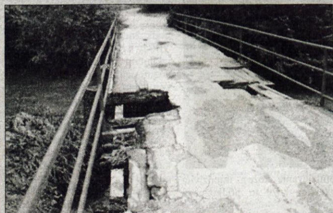
Povsem dotrajan in nevaren most čez Rupovščico.
