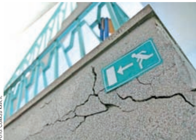
Šolska zgradba ni ne požarno ne potresno varna, razpokane zidove lahko vidimo na vsakem koraku.
