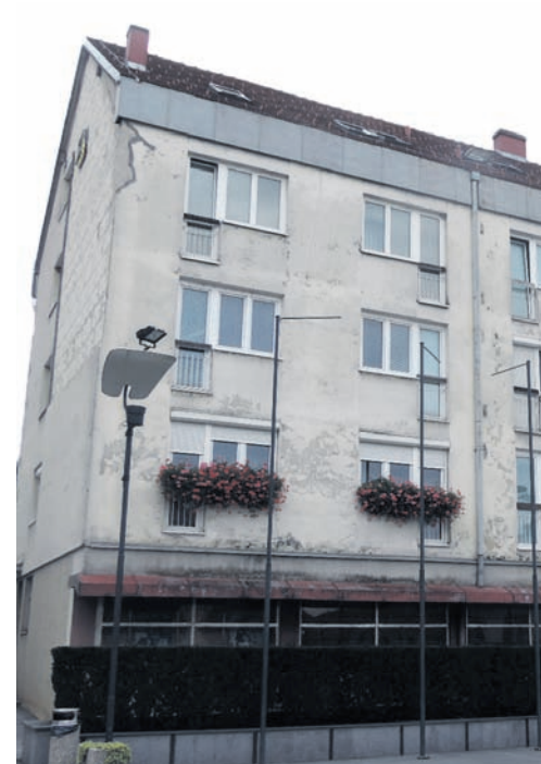
To je blok na Trgu svobode v Lenartu, za katerega zervni sklad, da bi obnovili dotrajano fasado. Šlo šanje pa je, koliko denarja – če sploh kaj – bodo
