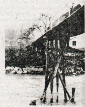
Med pomembnejšimi potrebnimi sanacijami je poleg Srednjega brda v krajevni skupnosti Gorenja vas tudi most v Železnikih.
